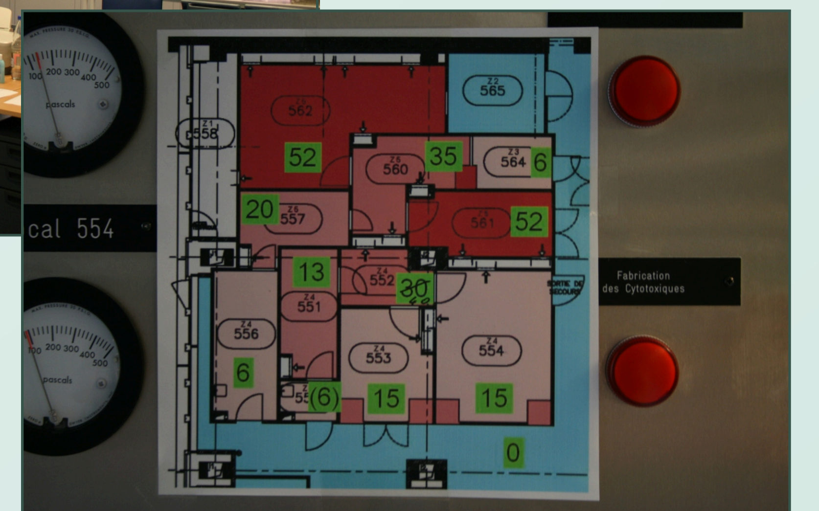
Système de sas et contrôle de pression des locaux
